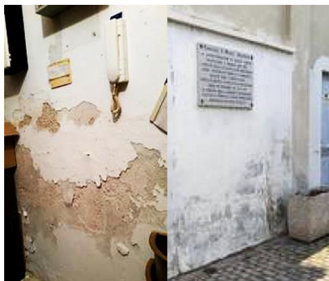
Alcune parti ammalorate del Ricreatorio, in manutenzione grazie a un contributo regionale.
